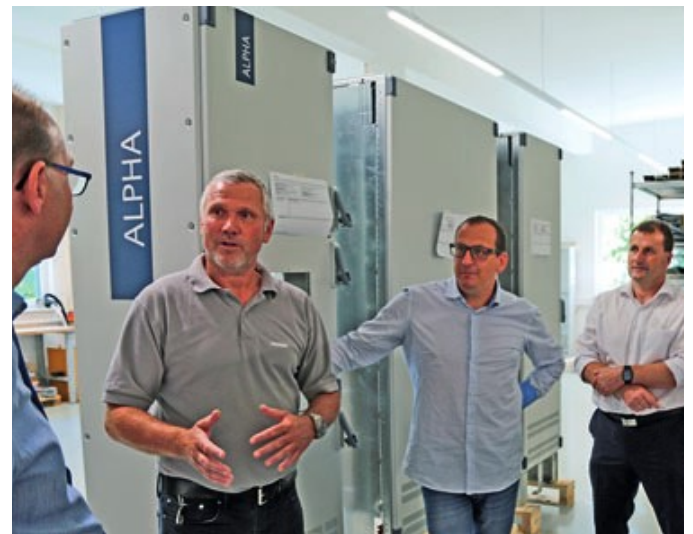
In der neuen geräumigen Werkstatt werden nun durch die Mitarbeiter selbst Schaltschranke produziert. Die geladenen Gäste konnten sich am 18. Juni vor Ort umsehen und bekamen auf Wunsch auch eine kleine Führung.
