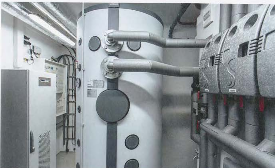
Bild 6: Im Pufferspeicher wird die Energie aus der Wärmepumpe bevorratet
