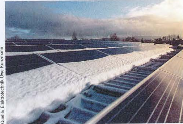
Bild 2: Die Photovoltaik-Anlage auf dem Dach des Firmengebäudes produziert den in der Regel selbst verbrauchten Solarstrom
